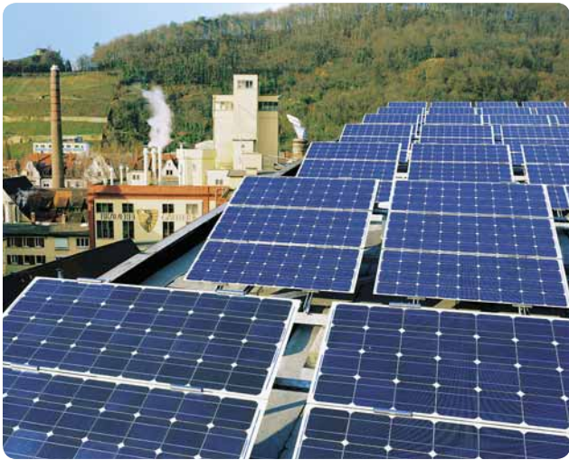
Brauerei Ganter, 70 kWp, Freiburg i. Br.
