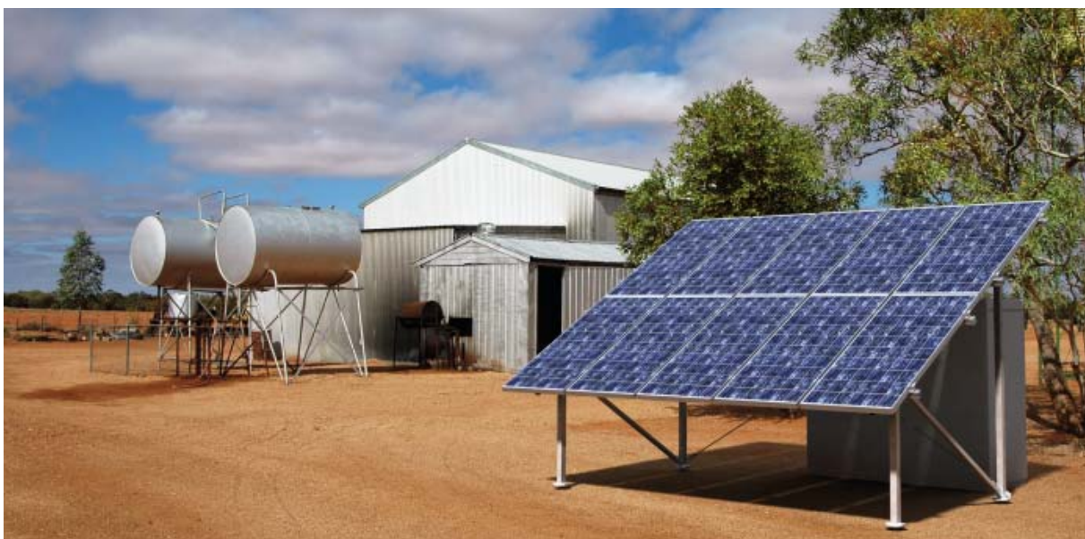
Photovoltaikanlage für einen Farmbetrieb Photovoltaic installation for a farm
